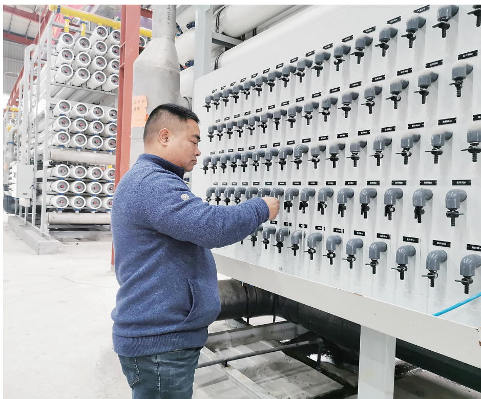
每个机组都有数十个取样阀,拧开阀门,流出的是脱盐后的淡水。
