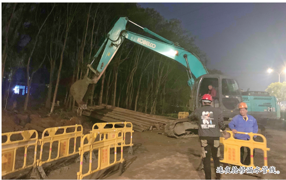
连夜抢修漏水水管线。居民用水。潘刚表示,他们已经和周边村进行协调,和相关管线单位做好对接,加快抢施工进度,预计今天傍晚完成抢修,夜间恢复供水。
