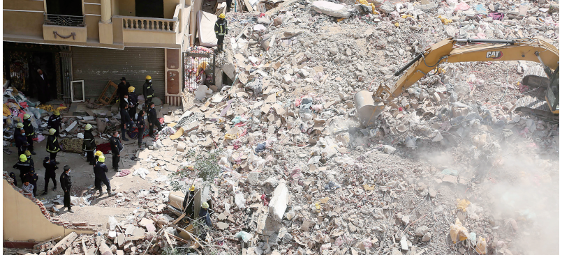
埃及首都开罗一栋楼房倒塌致5人死亡
