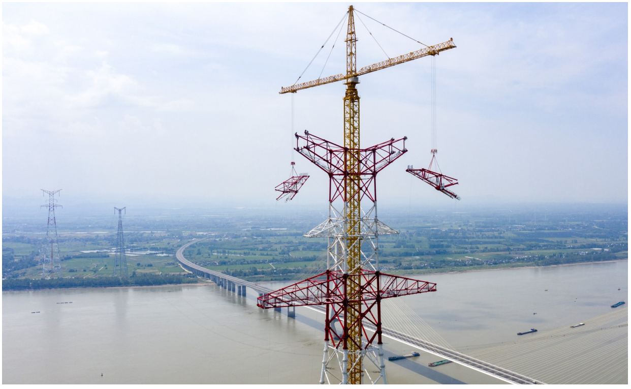
白鹤滩至浙江特高压直流输电工程安徽段长江跨越塔全部组立完成
