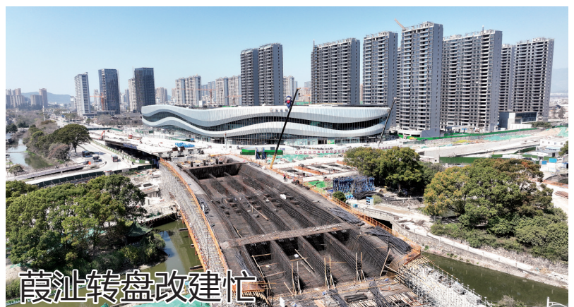
葭沱转盘改建忙 3月14日,葭沱转盘提升改造工程现场,工人正在进行云西路-82省道跨线桥桥墩绑扎。“跨线桥将作为转盘提升改造工程首个建成开建的项目。”工程项目总监徐明军介绍,整个转盘工程完成约48%。计划今年9月跨线桥完成通车,明年8月完成转盘整体提升改造。台传媒记者郭天宇摄
