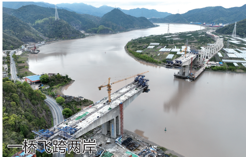
一桥飞跨两岸 3月30日,余姚至温岭公路(以下简称余温公路)临海汇溪至沿江段改建工程灵江特大桥主桥的施工现场,工人们通过“大于90天,实现关键节点突破”立功竞赛进一步推进项目高效建设。 余温公路作为省、市重点工程,是浙江省规划204省道的重要组成部分,也是台州境内的重要区域干线公路。其中,临海汇溪至沿江段改建工程是临海首个交通PPP项目,项目主线长约37.7公里,总投资36.3亿元。灵江特大桥是余温公路临海段关键控制性工程,大桥主桥设计跨径500米,跨径为全国第三的连续梁大桥。 台传媒记者孙金标摄
