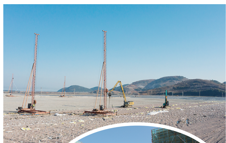
上图为台州湾新材料产业基础提升工程(一期)场平工程施工现场。
