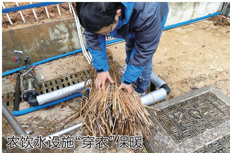
农饮水设施“穿衣”保暖 近日气温骤降,裸露在外的水管和流量计等设施可能会被冻裂,12月19日,天台县清源水务运营有限公司的工作人员为它们穿上了保暖“外套”。图为工作人员在现场为流量计包裹保温棉、铺设稻草防冻。台传媒记者徐莎莎摄
