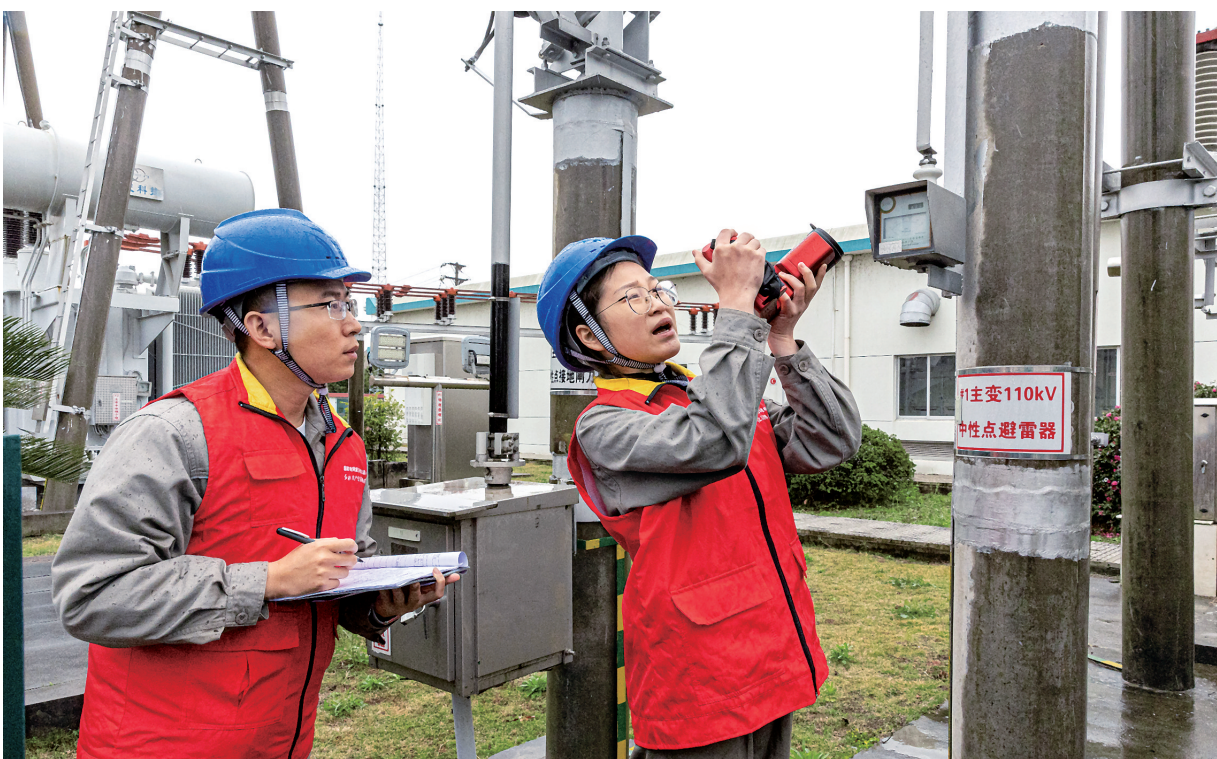
设备“体检” 战寒潮保供电
