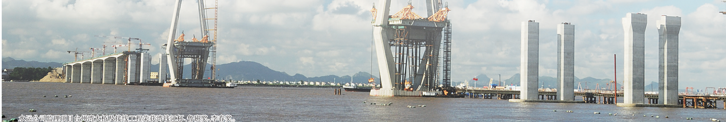
永运公司监理项目台州湾大桥及接线工程荣获钱江杯、鲁班奖、李春奖。
